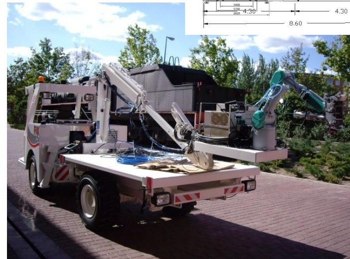
Robots de inspección y mantenimiento de túneles
